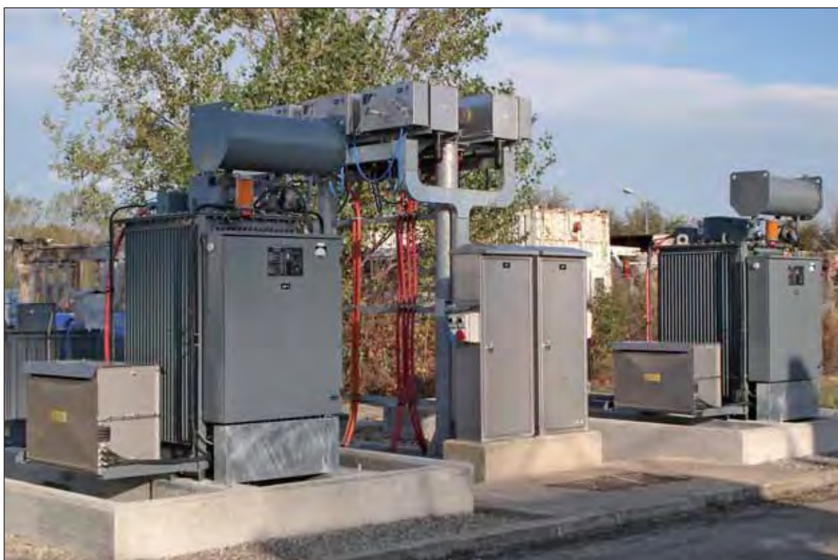
Рис. 1: Установка с воздушными линиями 110/20 кВ с заземляющими дугогасящими реакторами
